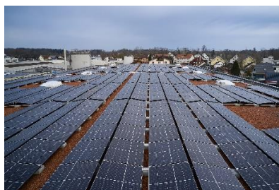
toit avec modules photovoltaïques
